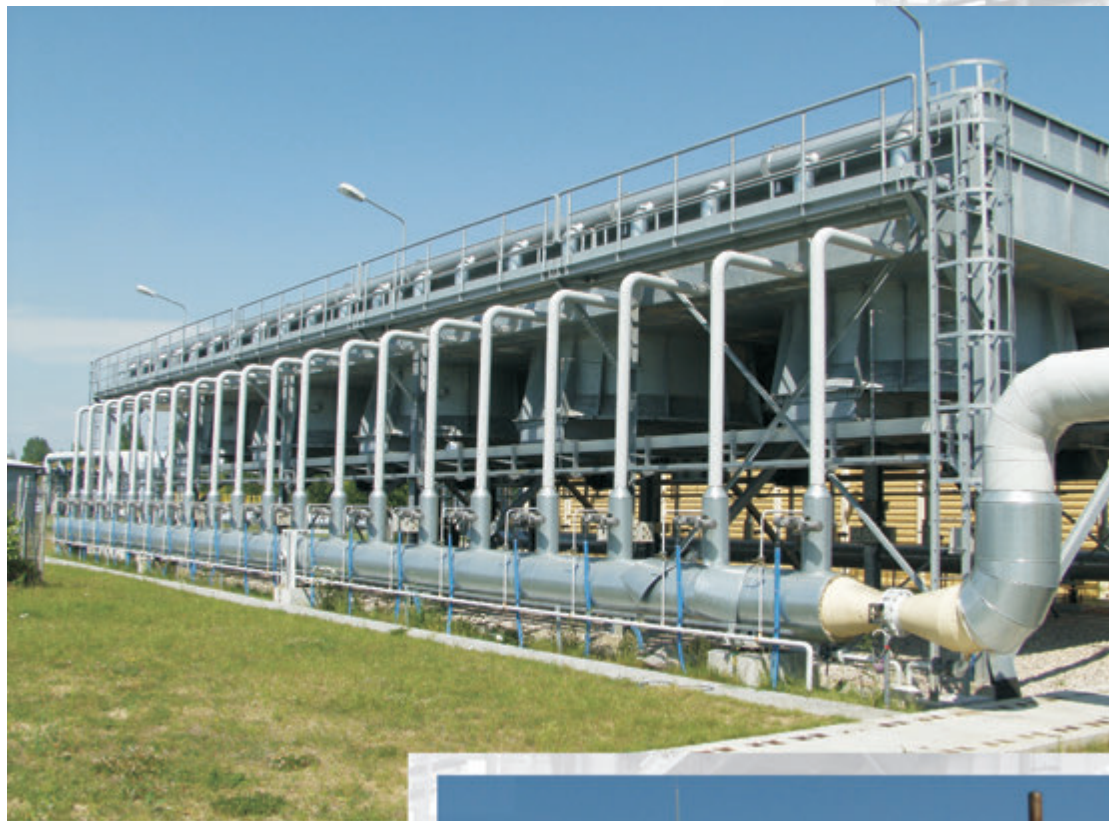
Chłodnica powietrzna wody w elektrowni
