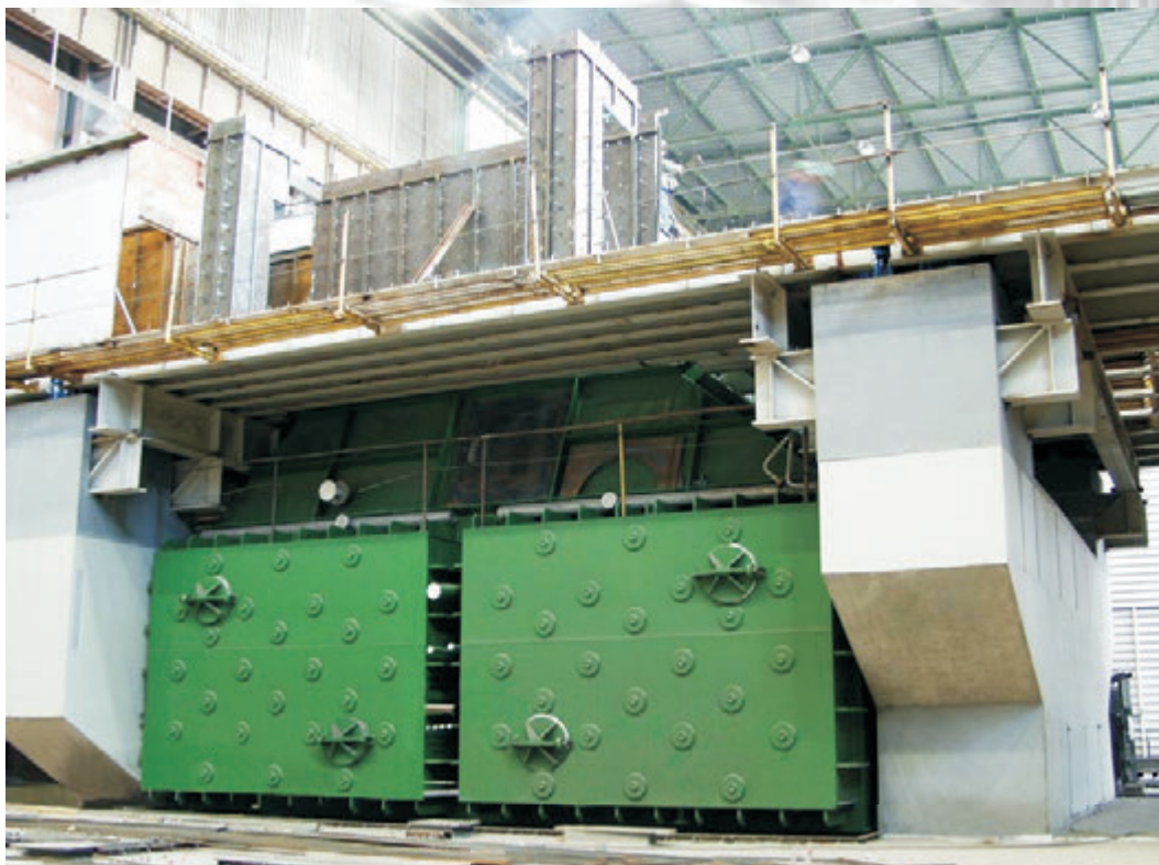
Kondensator pary z turbin zainstalowany w elektrowni
