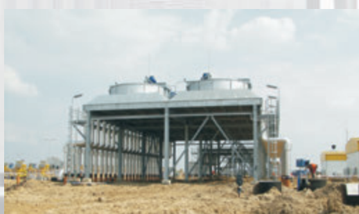
Bateria chłodnic gazu ziemnego
