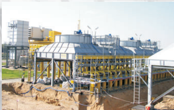
Kolektory w tłoczni gazu ziemnego
