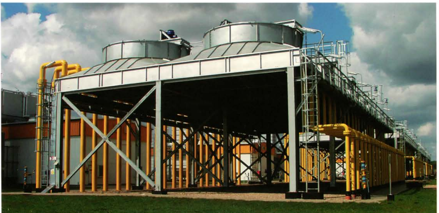
Батарея аппаратов воздушного охлаждения – Газокомпрессорная станция.
