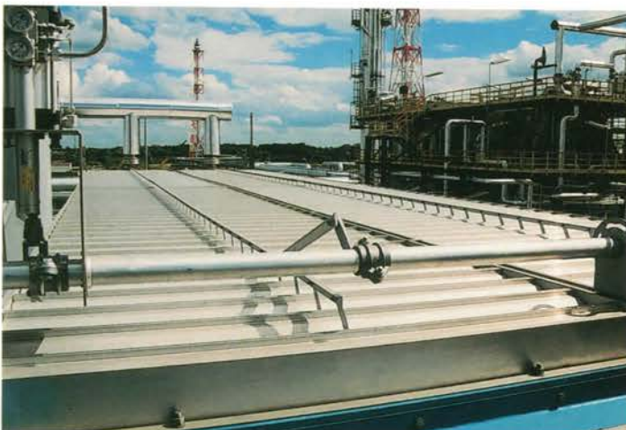
Автоматическое жалюзи аппарата воздушного охлаждения. Automatically controlled air cooler louvers.
