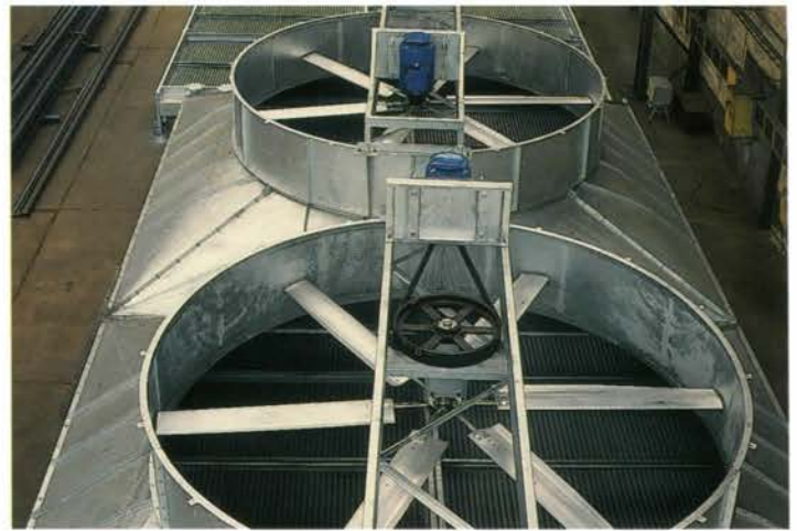
Вентиляторы аппаратов воздушного охлаждения (АВО), смонтированные по системе „на всасывание“. Fans installed in induced draft air coolers.
