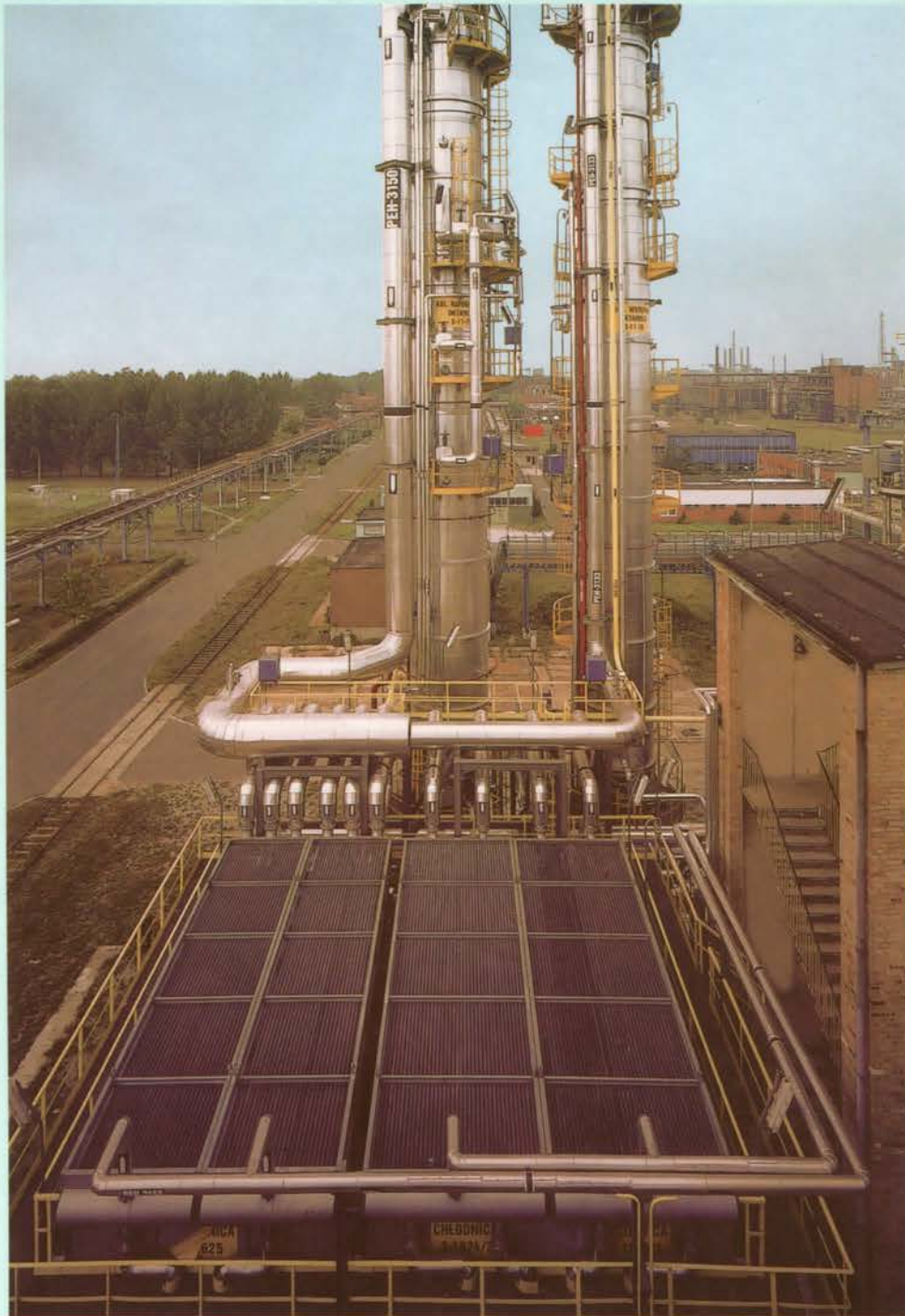
Аппарат воздушного охлаждения на установке химического синтеза. Air cooler installed in chemical synthesis plant.
