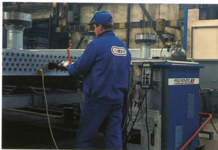
Орбитальная (круговая) сварка труб со стенкой камеры через контрольные (инспекционные) отверстия. Orbital welding of tubes to header tube sheet through inspection holes.
